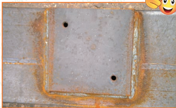
Photo 50 : Trous d'évent et soudure continue
